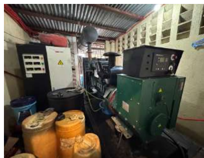
発電機・浄水室完備
